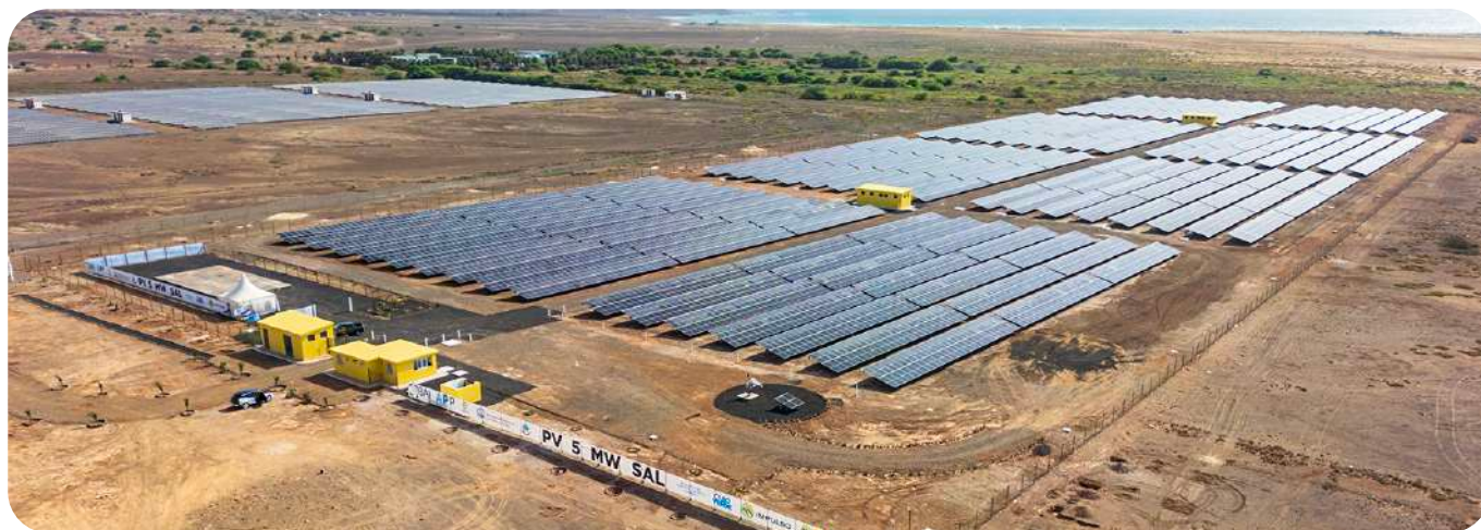
Parque solar fotovoltaico, Cabo Verde
